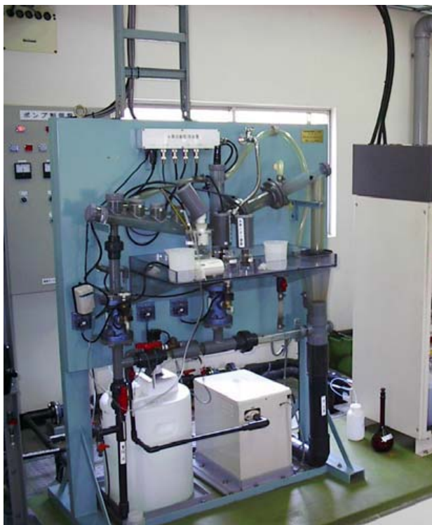
新橋水質自動監視装置
