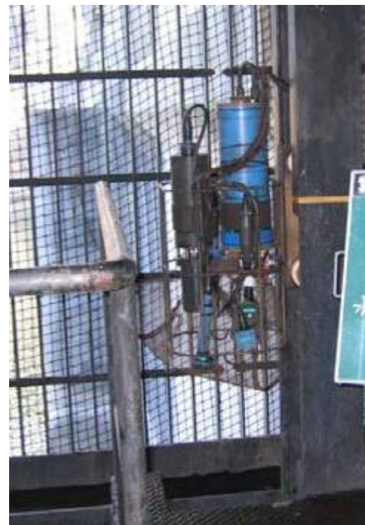
島地川ダム水質自動監視装置
