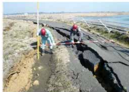
液状化による河川堤防への被害(茨城県東茨城郡茨城町) 5)
