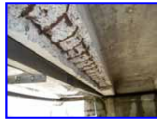
塩害により主桁に発生した剥離・鉄筋露出 ・R31吉屋橋 (建設後60年経過H19補修済み)
