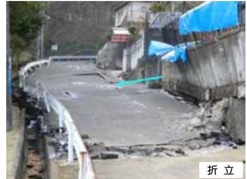
仙台市周辺などの宅地造成の盛土崩壊 6)
