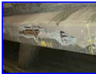
経年劣化及び中性化による主桁コンクリートの剥離及び鉄筋露出 ・R2山王橋 (建設後54年経過H19補修済み)
