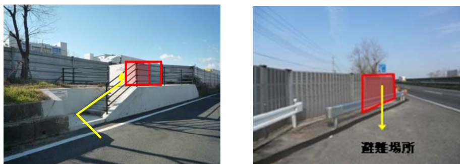
写真4 緊急避難階段の整備例
