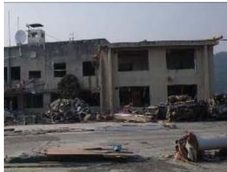
写真3 自治体庁舎の被災
