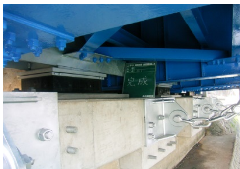
写真11 落橋防止装置の例
