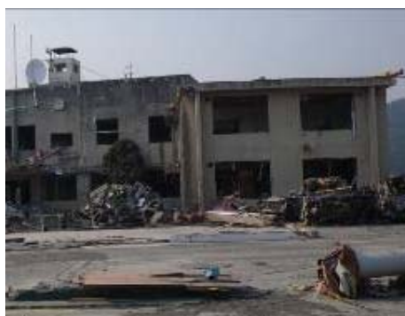
写真３ 自治体庁舎の被災
