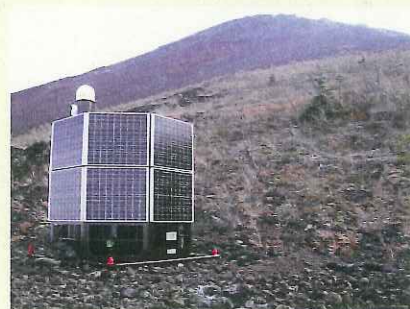
火山の噴火などによる地殻変動をより詳細に捉えるため、山体等に臨時のGNSS火山変動リモート観測装置 (REGMOS)を設置しています。
