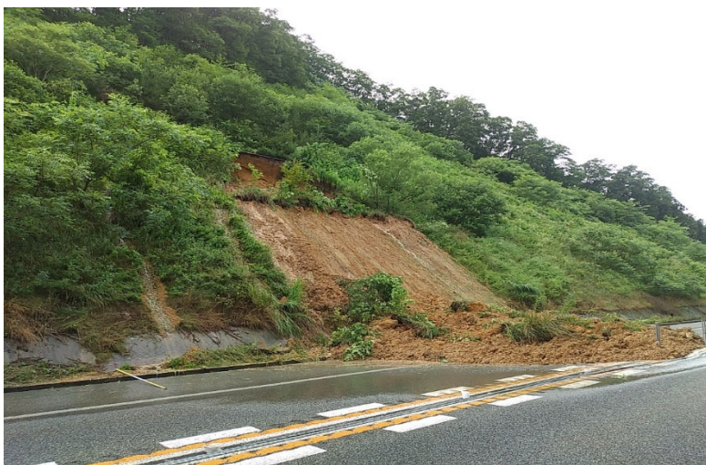
大雨による法面崩落 松江道 広島県庄原市高野町 令和3年7月12日
