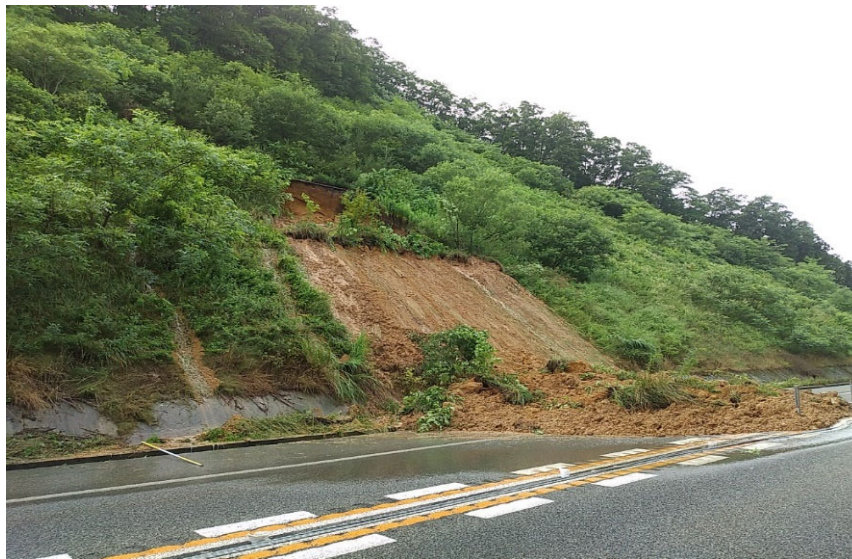
大雨による法面崩落 松江道 広島県庄原市高野町 令和3年7月12日
