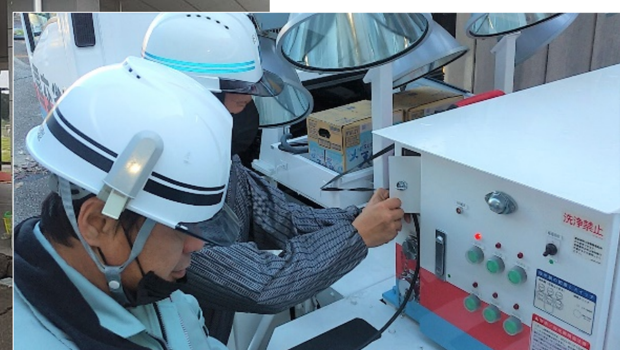
照明車による電源供給支援(石川県珠洲市 現地支援班)
