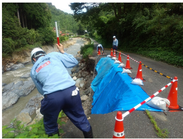
調査状況 (道路班2) おわい とっとり さじ おわい (市) 尾際線 (鳥取市佐治町尾際)
