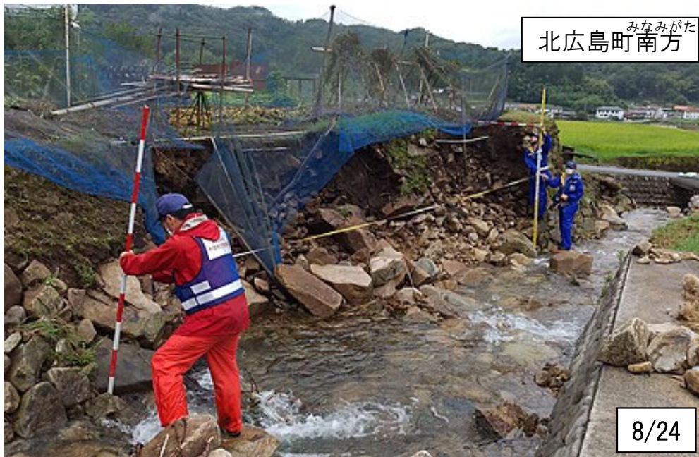
現地調査 (被災状況調査班)
