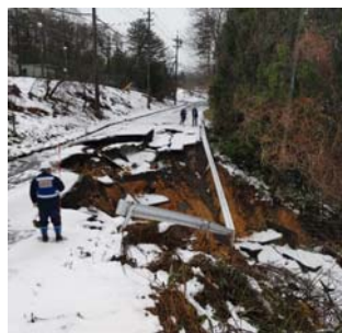
道路被害状況の調査
