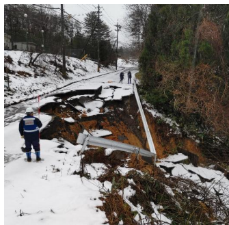
道路被害状況の調査
