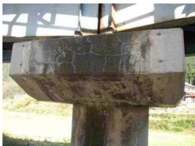
対策前(建設後 28 年経過)
