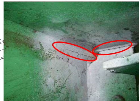
交通荷重により主桁に発生した 疲労亀裂
