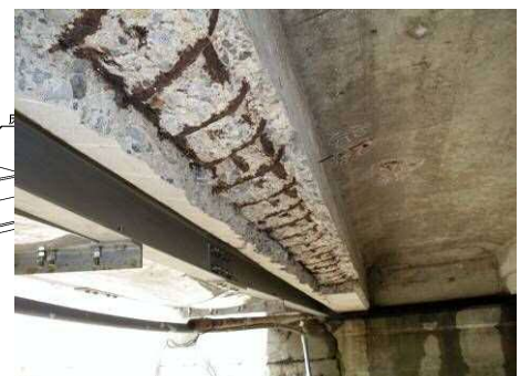
塩害により主桁に発生した 剥離・鉄筋露出
