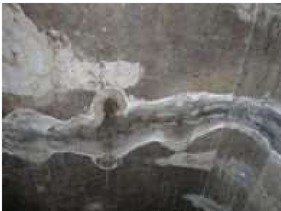
②頂版部のひび割れと漏水
