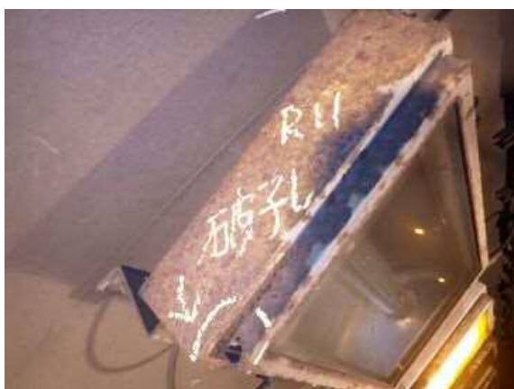
照明器具の腐食
