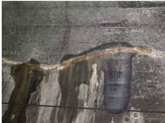
漏水を伴ったひび割れ
