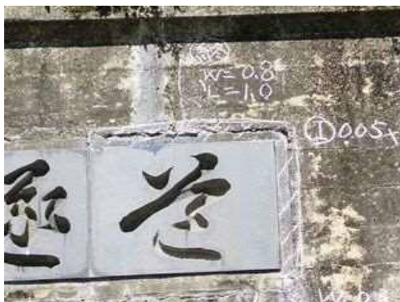
トンネル名板周辺部のうき
