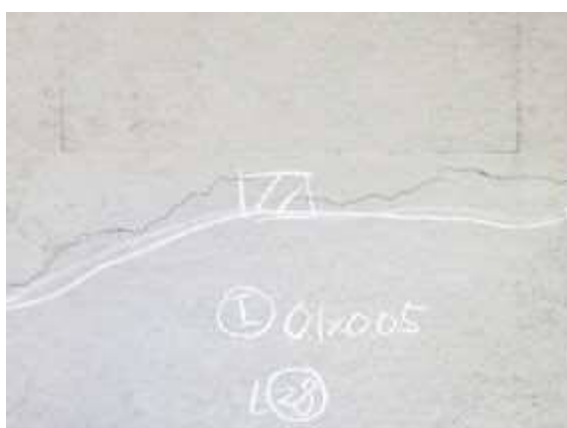
ひび割れ沿いのうき
