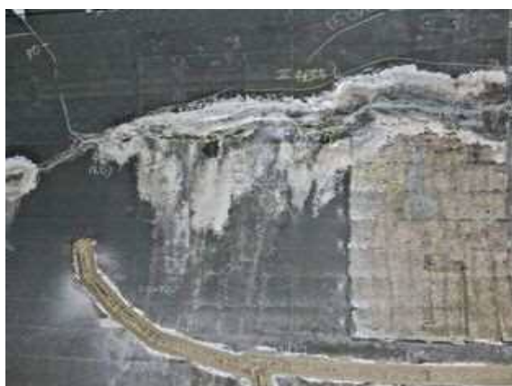
ひび割れ沿いのうき
