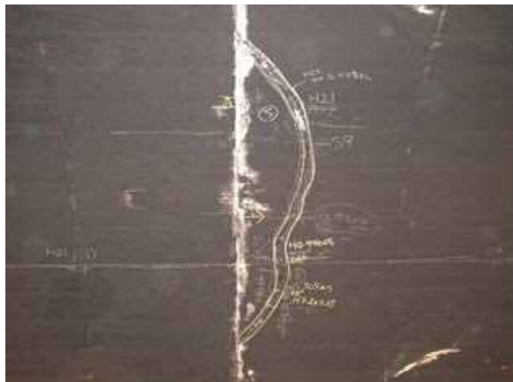
横断目地部に閉合するひび割れ
