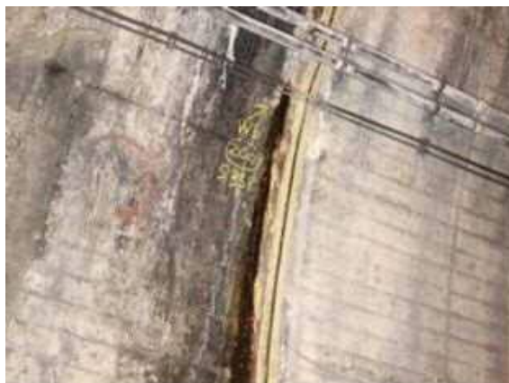
横断目地部付近からの漏水
