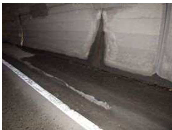
漏水による路面滞水
