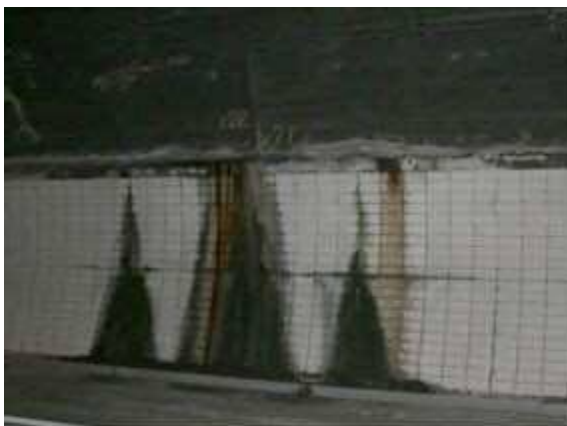
水平打継目部からの漏水
