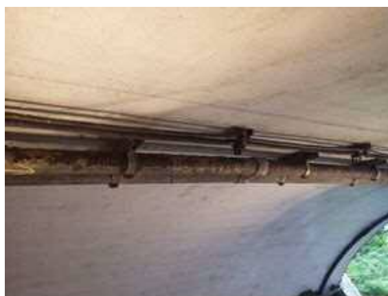
ケーブル保護管腐食
