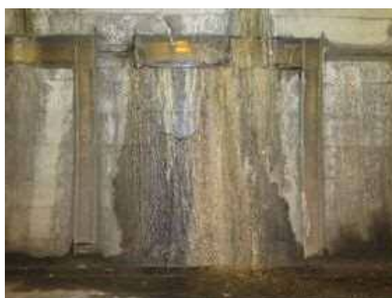
水平打継目部からの漏水
