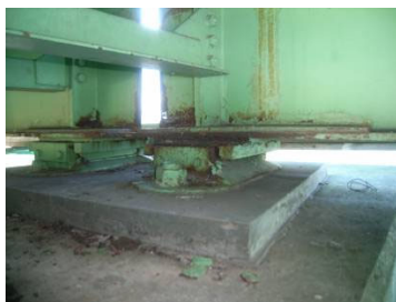
対策前(建設後37年経過)
