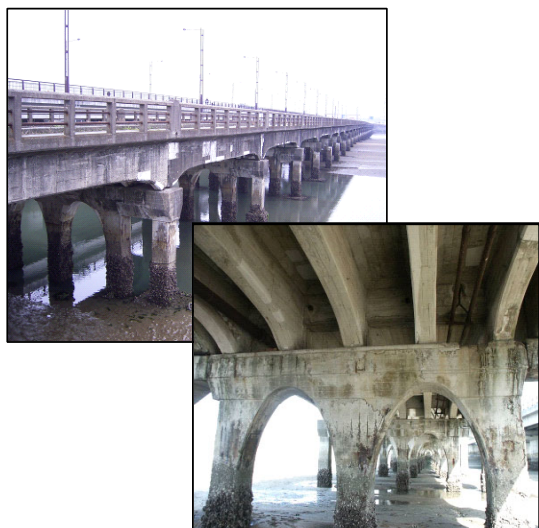
国道190号 厚東川大橋(山口県宇部市藤曲) ・1935年建設 (コンクリート橋) ・塩害による主桁、下部工の損傷が激しいため、 1997年架替 (経年数62年)
