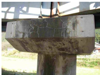
対策前(建設後28年経過)
