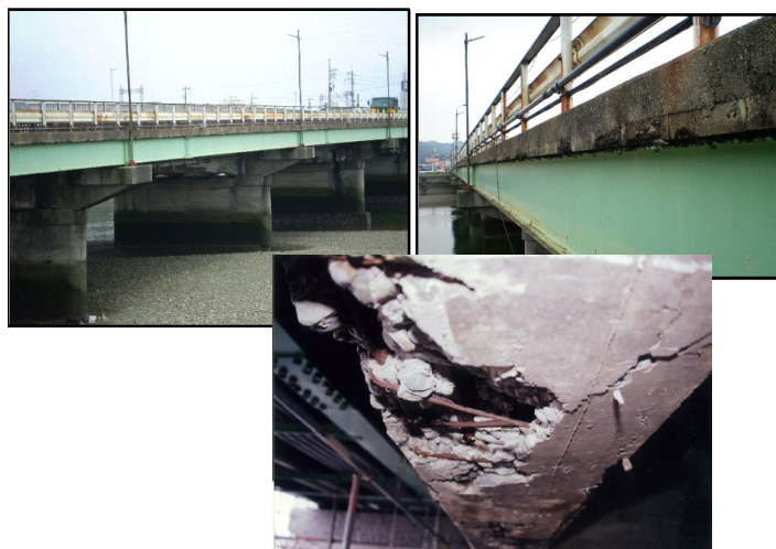
国道188号 新寿橋(山口県岩国市川下町) ・1953年建設 (コンクリート橋+鋼橋) ・主桁、下部工の損傷が激しいため、 2007年架替 (経年数54年)
