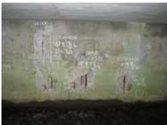
①側壁部のうき、はく離(鉄筋露出)
