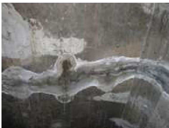
②頂版部のひび割れと漏水
