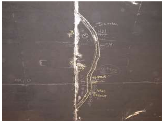
横断目地部に閉合するひび割れ
