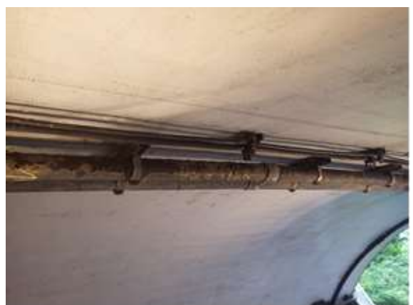
ケーブル保護管腐食
