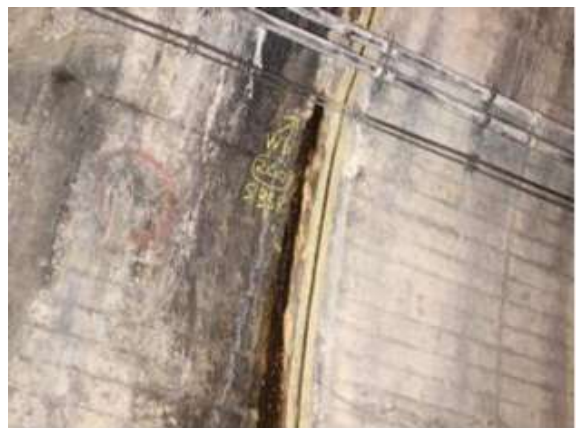
横断目地部付近からの漏水
