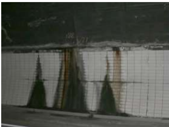
水平打継目部からの漏水
