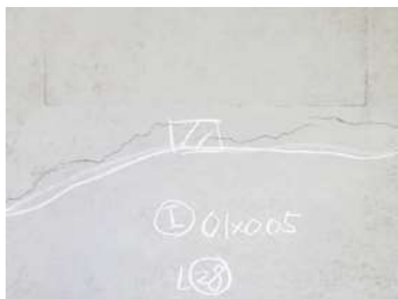
ひび割れ沿いのうき
