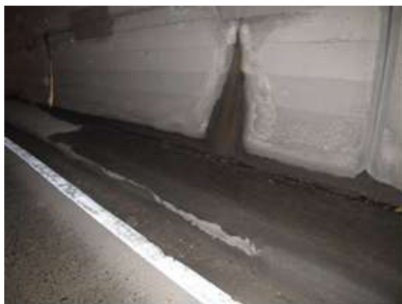
漏水による路面滞水
