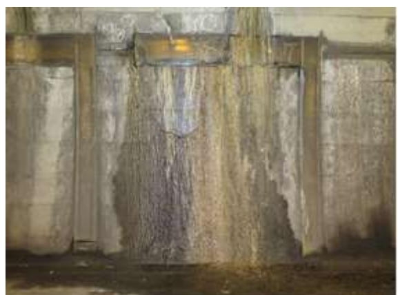
水平打継目部からの漏水
