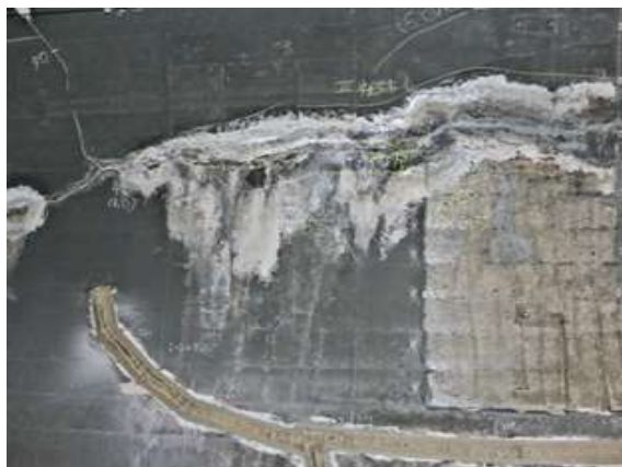
ひび割れ沿いのうき
