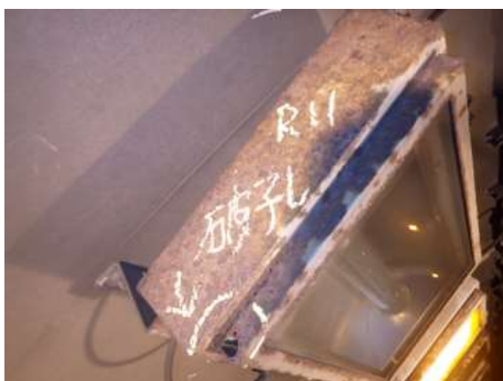
照明器具の腐食
