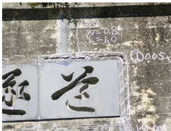
トンネル名板周辺部のうき
