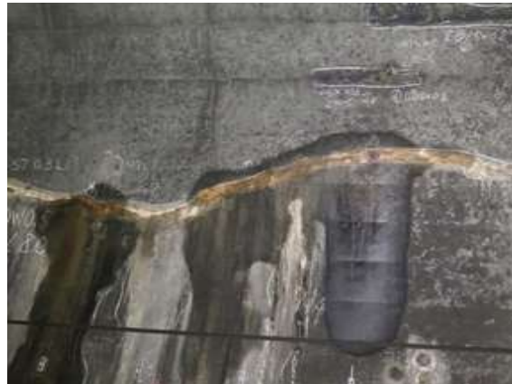
漏水を伴ったひび割れ
