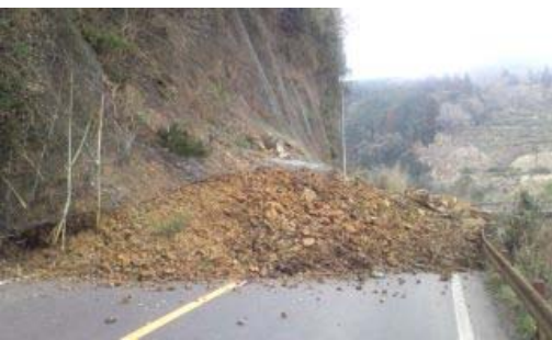
▲長門市俵山大羽山 【H24.2 被災状況】
