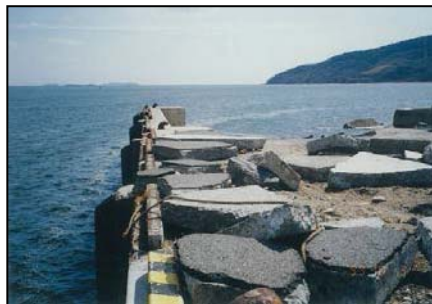
施設の被災状況(築地2号岸壁) H11.9.24 台風18号
