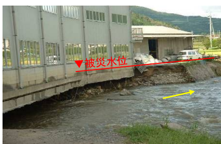
支川玖島川玖島地区の河岸侵食
