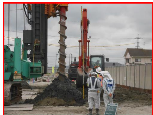
【地盤改良時に盛り上がり土が発生】
