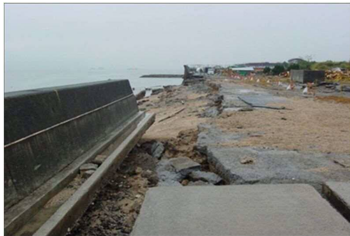
整備前の被災状況（観音）
