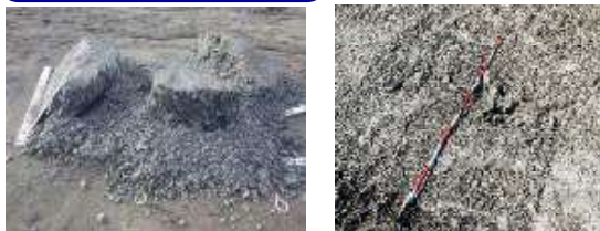
スレーキング(細片化)の状況。 のり面表面の軽微な崩壊が発生している。
