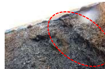
【写真②】切土のり面 崩落状況
