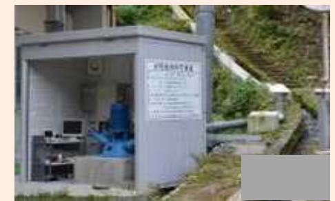
小水力発電設備
