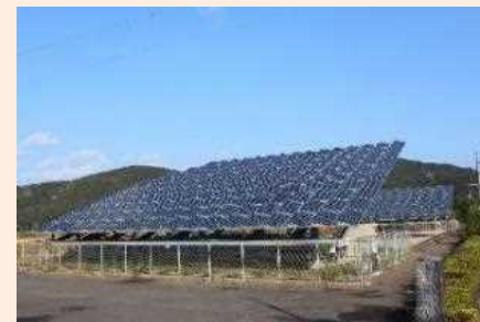
太陽光発電設備
