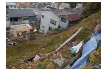
高台にある所有者不明土地から、瓦礫や岩石、柵等が落下するおそれ
