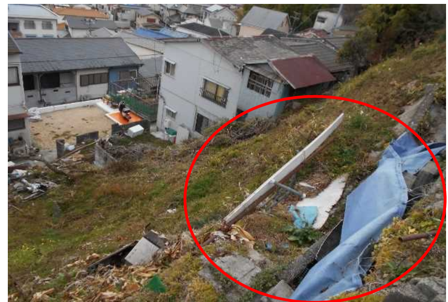
当該土地は高台に位置しており、強風・豪雨等の 際には、 瓦礫や柵等の落下 が懸念されており、 低地の住民にとっては非常に危険な状況
