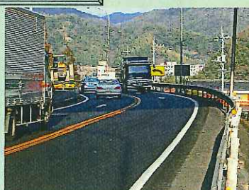
▲写真① 戸田山付近線形不良状況
