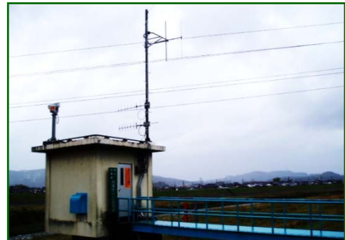
老朽化した通信アンテナ
