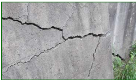
劣化による損傷で亀裂の入った護岸
