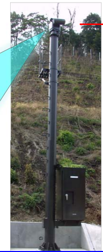
CCTVカメラ装置
