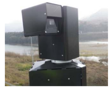
CCTVカメラの設置例
