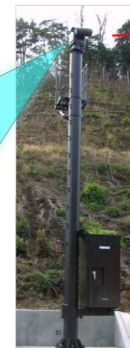
CCTVカメラ装置
