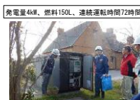
非常電源設備
