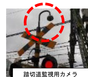
踏切道監視用カメラ
