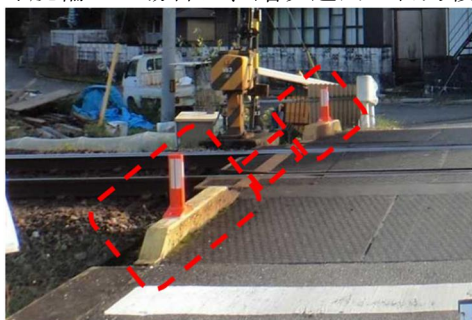
写真 2-7-32 踏切道端部のブロック、ラバーポール及び路面標示の設置事例
