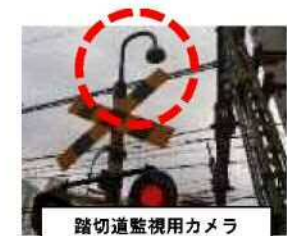
踏切道監視用カメラ
