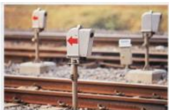
踏切支障報知装置
