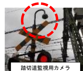
踏切道監視用カメラ
