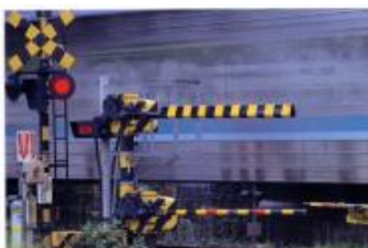
大型遮断機 +二段型遮断装置
