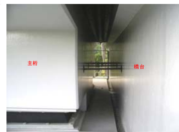
桁端部遊間確保と塗装事例
