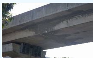
PC床版：漏水、遊離石灰
