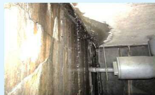
伸縮装置：漏水
