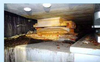
支承：腐食、滞砂
