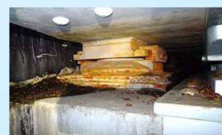
支承：腐食、滞砂
