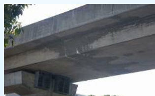
PC床版：漏水、遊離石灰
