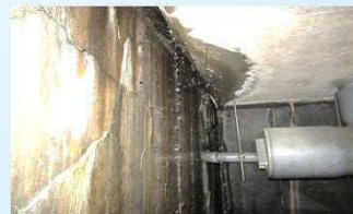
伸縮装置：漏水
