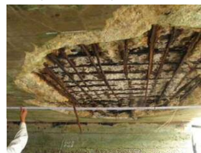
床版鉄筋露出
