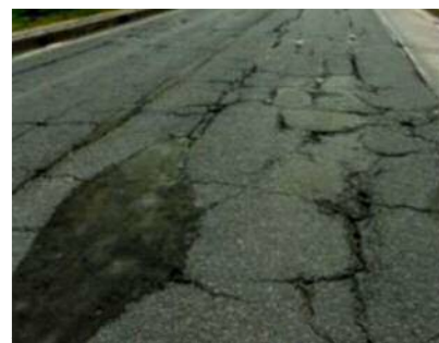
アスファルト舗装ひび割れ
