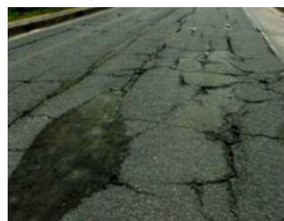
アスファルト舗装ひび割れ
