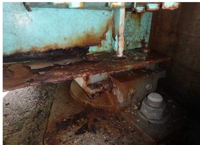
地方自治体管理 主桁腐食
