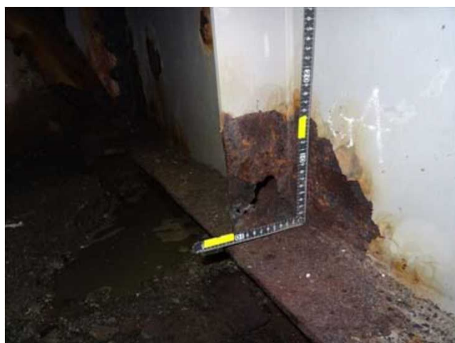
国管理 主桁腐食・欠損
