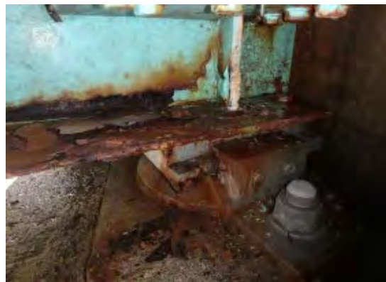
地方自治体管理 主桁腐食
