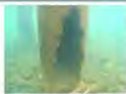
▲パイルベントの断面欠損
