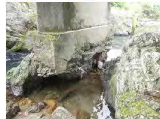
地方自治体管理 橋脚洗掘
