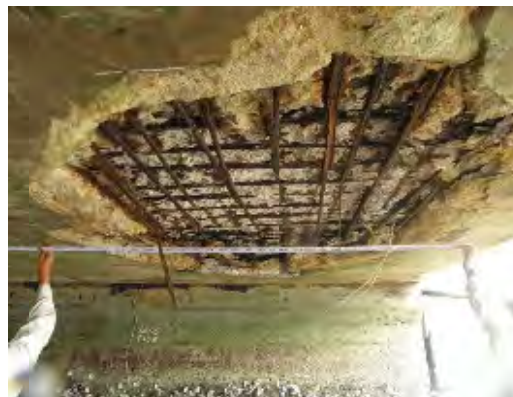
地方自治体管理 床版鉄筋露出
