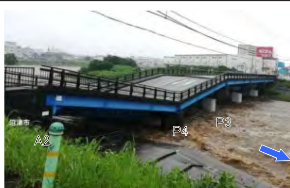
P4橋脚の沈下・傾斜
