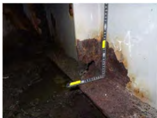
国管理 主桁腐食・欠損
