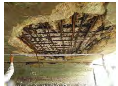
地方自治体管理 床版鉄筋露出
