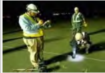
&lt;ひび割れ計測&gt;
