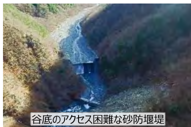
砂防施設は狭隘な山間部にあり、点検効率が悪く危険性が高い
