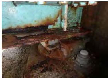
地方自治体管理 主桁腐食
