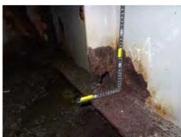
国管理 主桁腐食・欠損
