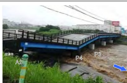
P4橋脚の沈下・傾斜
