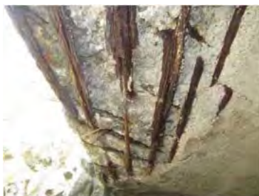
国管理 床版鉄筋露出 ※床版:橋の裏側
