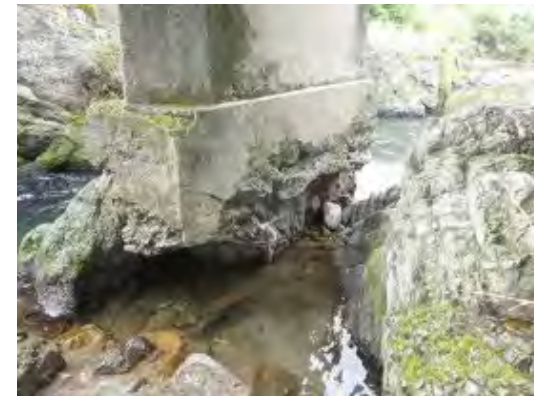
地方自治体管理 橋脚洗掘
