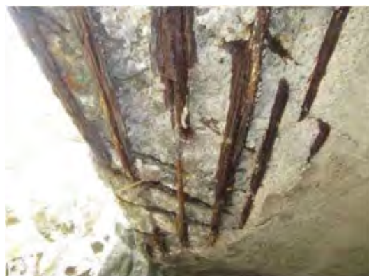
国管理 床版鉄筋露出
