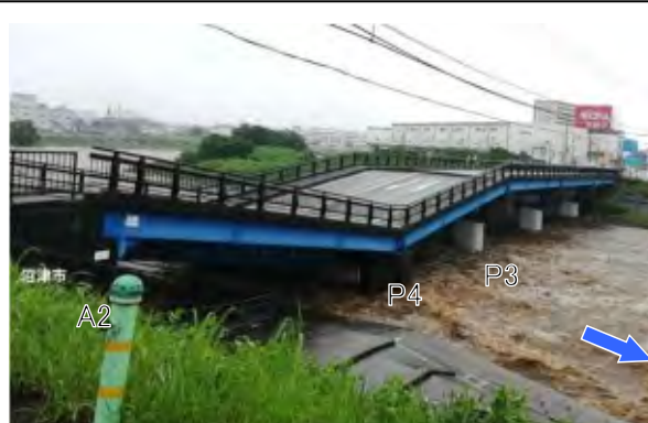
P4橋脚の沈下・傾斜
