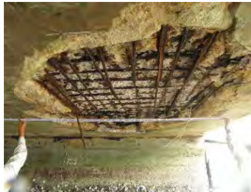
地方自治体管理 床版鉄筋露出
