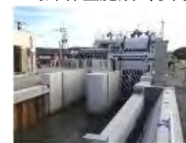
下水道施設 (雨水ポンプ場)
