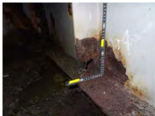
国管理 主桁腐食・欠損
