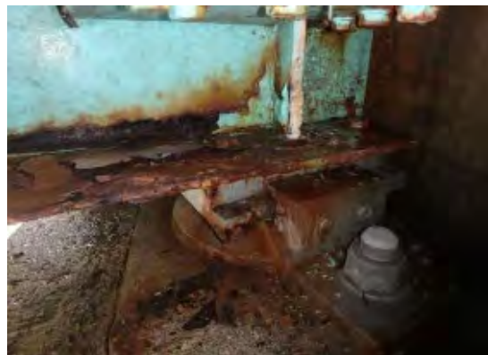
地方自治体管理 主桁腐食
