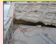
クラックが生じた河川護岸
