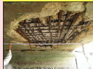
内部の鉄筋が露出した橋梁
