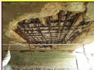
内部の鉄筋が露出した橋梁
