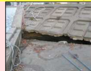
クラックが生じた河川護岸
