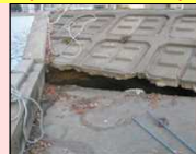
クラックが生じた河川護岸
