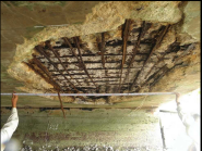
内部の鉄筋が露出した橋梁 早期に措置が必要な施設の例
