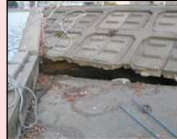
クラックが生じた河川護岸
