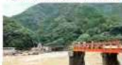
令和2年7月豪雨、熊本県道
