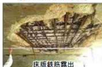
床版鉄筋露出
