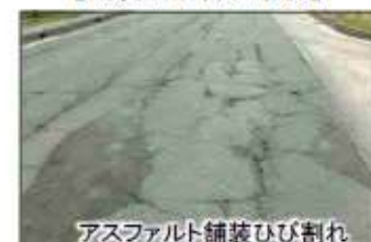
アスファルト舗装ひび割れ
