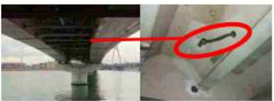
縦リブ等に多数の疲労亀裂が発生
