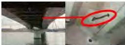
縦リブ等に多数の疲労亀裂が発生
