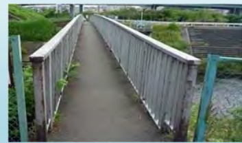
橋梁点検車が入れない
